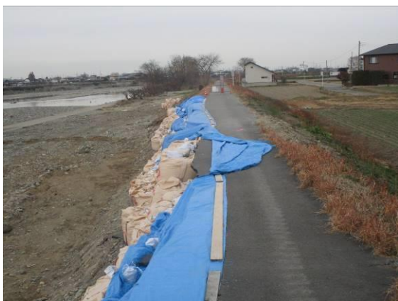
激しい流れにより削られた鍋川の堤防
