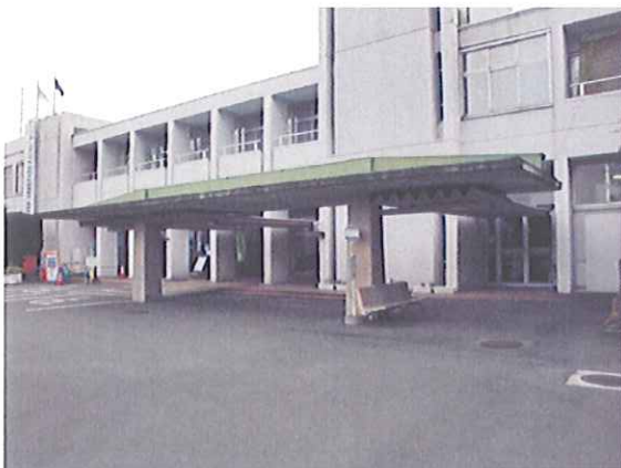
③-1 本庁舎 エントランス車寄せ 庇にコンクリートの剥離が見られる
