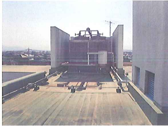
① 本庁舎 屋上 クーリングタワー 未使用設備機器が放置されており落下転倒の可能性がある
