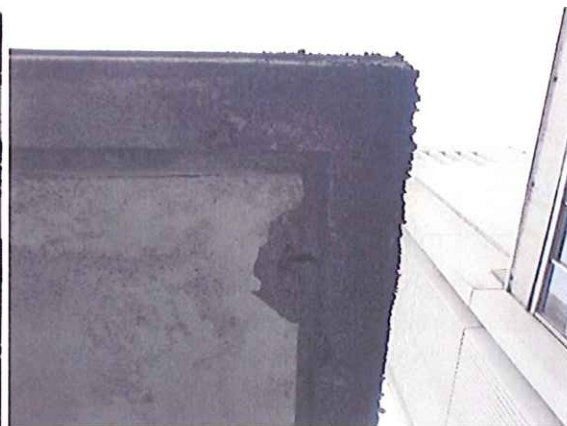
③-2 本庁舎 エントランス車寄せ 庇コンクリート剥離状況 内部鉄筋が露出している
