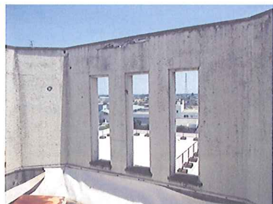
⑤-2 東庁舎 シート防水の劣化状況 防水の改修が望ましい
