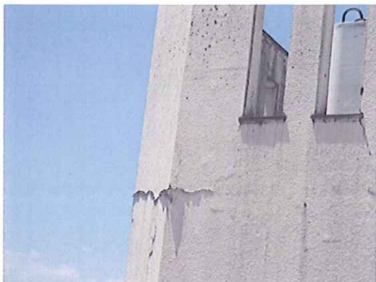
②-3 東庁舎塔屋 壁のひび割れ 躯体内部確認後補修が望ましい
