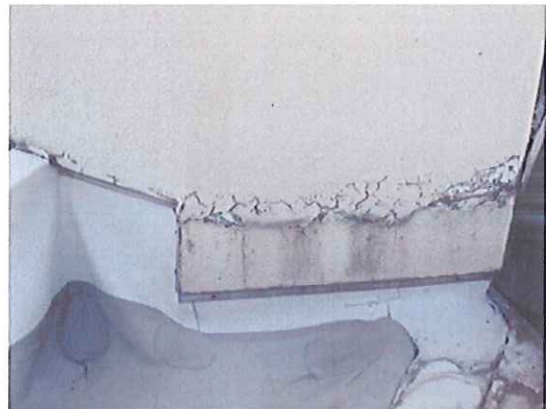
②-2 東庁舎塔屋 壁のひび割れ 躯体内部確認後補修が望ましい
