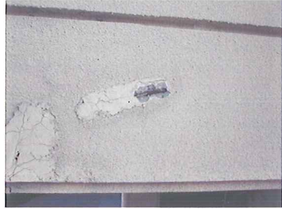
③-2 東庁舎外部階段 鉄筋被り不足 剥離部の補修が望ましい
