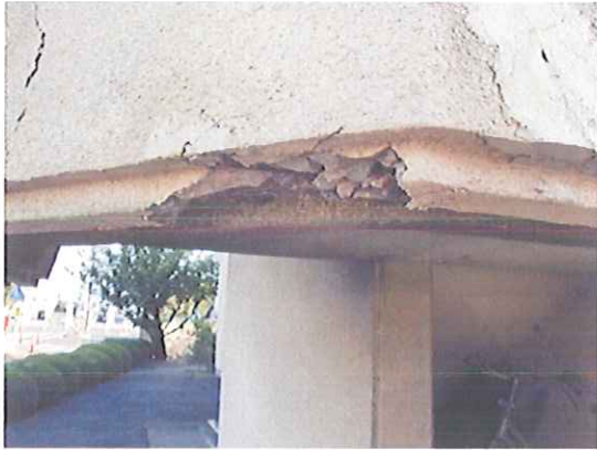
③-1 東庁舎外部階段 コンクリート剥離 剥離部の補修が望ましい
