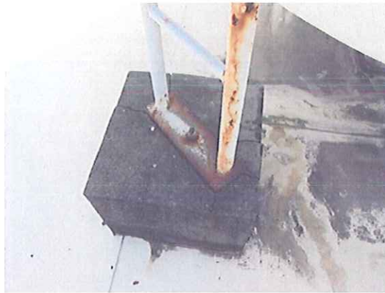
① 東庁舎屋上 設備基礎 建物躯体との接合が望ましい
