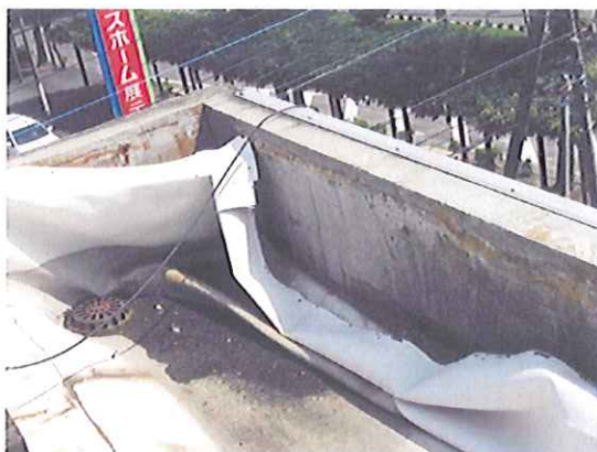
⑤-1 東庁舎 シート防水の劣化状況 防水の改修が望ましい
