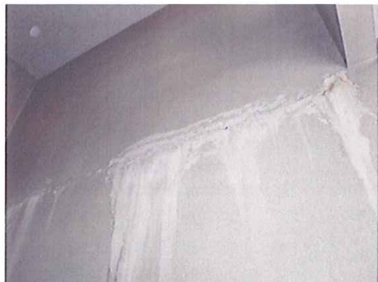
②-4 東庁舎塔屋 壁のひび割れ 躯体内部確認後補修が望ましい
