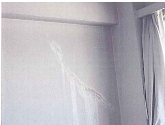
②-1 東庁舎3階 耐力壁のひび割れ 樹脂充填等による補修が望ましい
