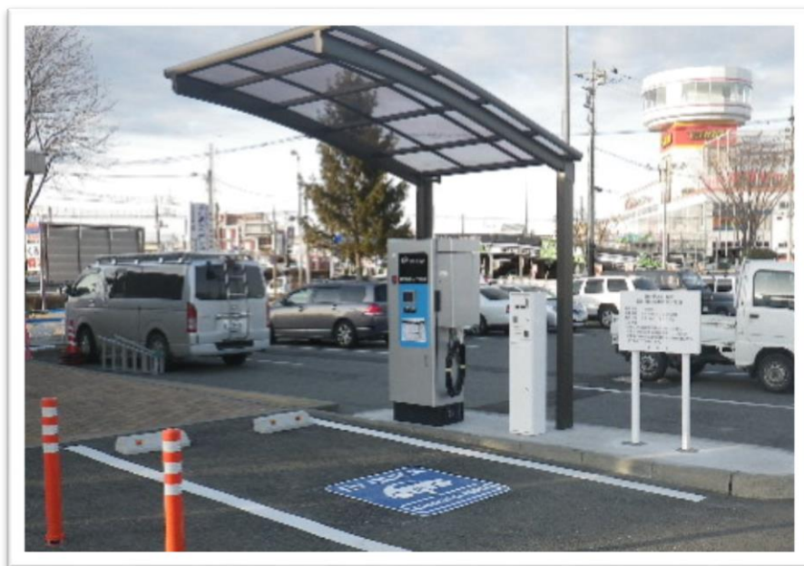
電気自動車用急速充電器(道の駅「ららん藤岡」)
