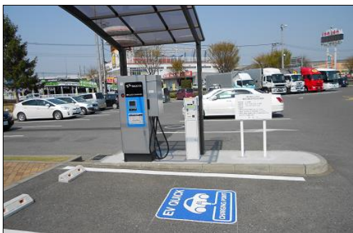
《①道の駅ふじおかEV急速充電器》
