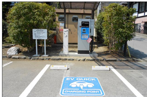
《②道の駅上州おにしEV急速充電器》
