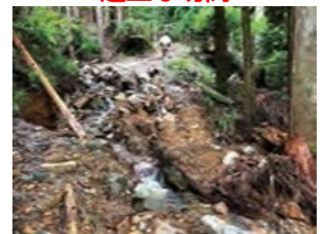
谷に盛土した作業道の崩壊
