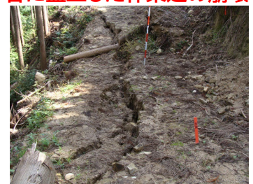
盛土で発生したクラック
