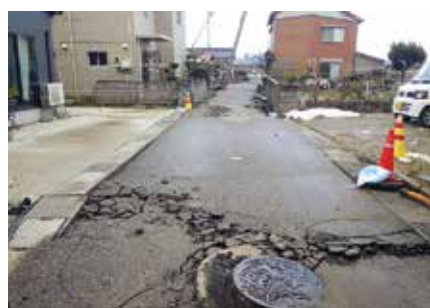
▲発災当初に撮影した羽咋市内の道路被害状況
