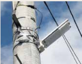
第71区に整備した防犯灯
