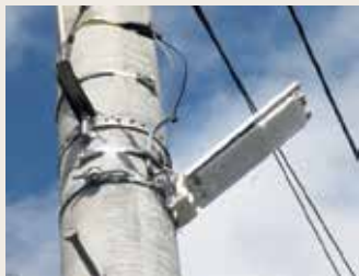
第71区に整備した防犯灯
