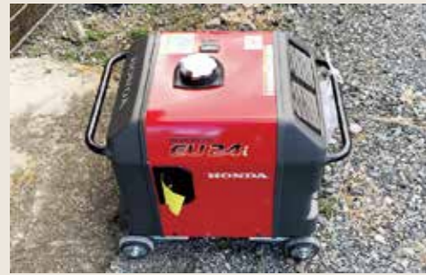
温井公会堂に整備した発電機
